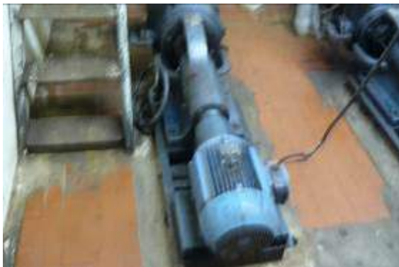
Motores Elevatória Saldanha Marinho US-II . (Fonte STE)
