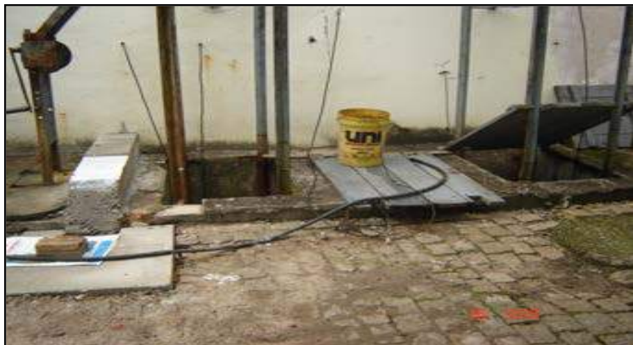
Figura 11 - Chegada do efluente na ETE (Fonte STE)
