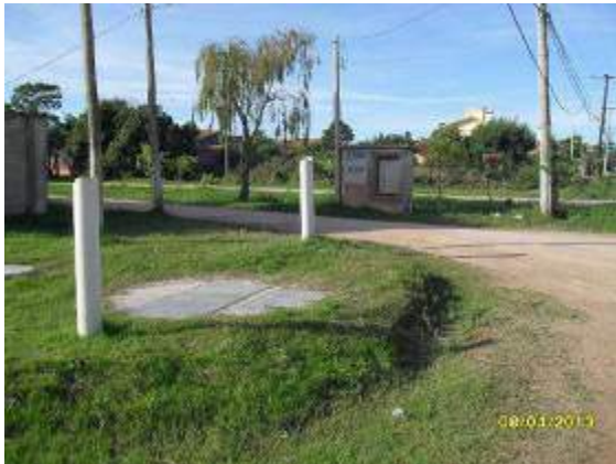
Local da Elevatória L3. (Fonte SANEP)
