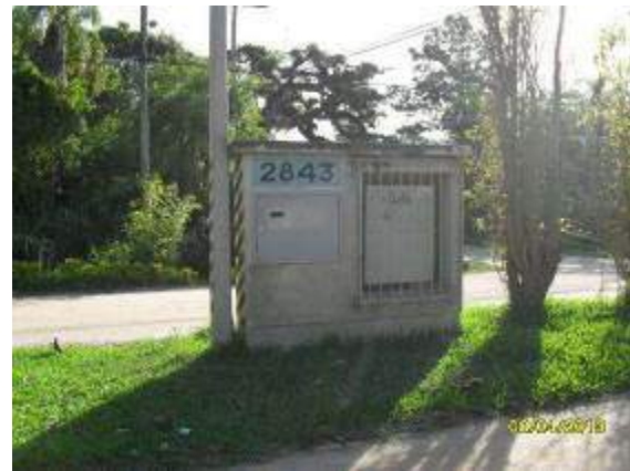
Quadro de comando ELE - L2. (Fonte SANEP)
