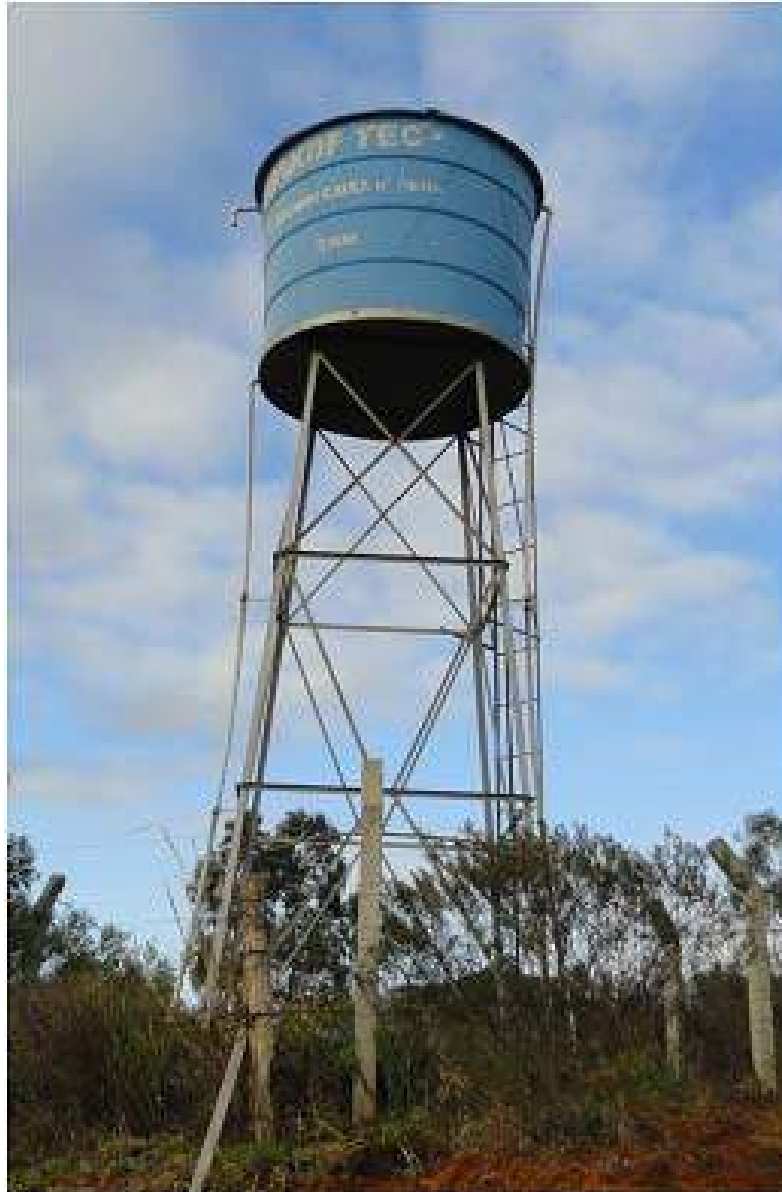
Ilustração 023 – Por último, outra caixa d’água, também de 5.000 litros, é abastecida, indiretamente, pelo MB-3. Serve, também, como amortecimento de energia da água e possui tubulações de entrada e saída com mesmo diâmetro, ambas DN 50.
