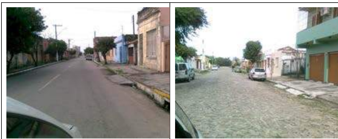
Figura 10: Dispositivos de microdrenagem superficial
