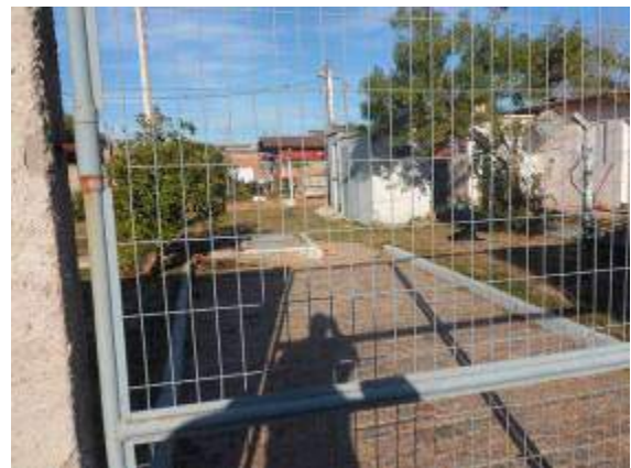
Quadro de comando ELE – Navegantes. (Fonte SANEP)
