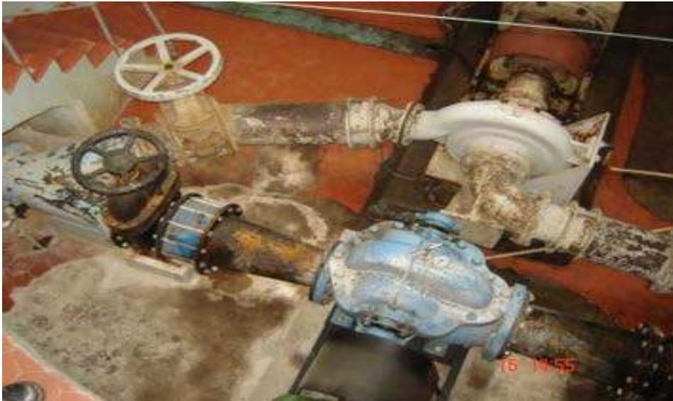
Ilustração 31 - Conjunto motobomba 3ª EEAT
