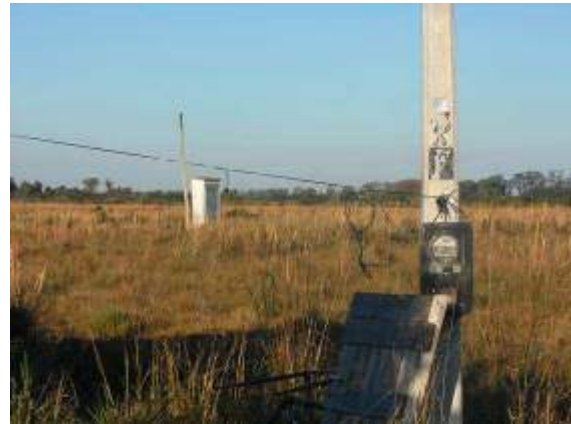
Quadro de comando ELE – Ceval. (Fonte SANEP)
