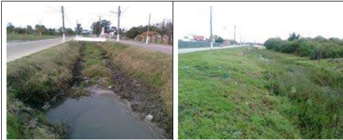
Figura 26: Avenida Gonçalves Ledo, Estação Rodoviária, ponto crítico de alagamento.
