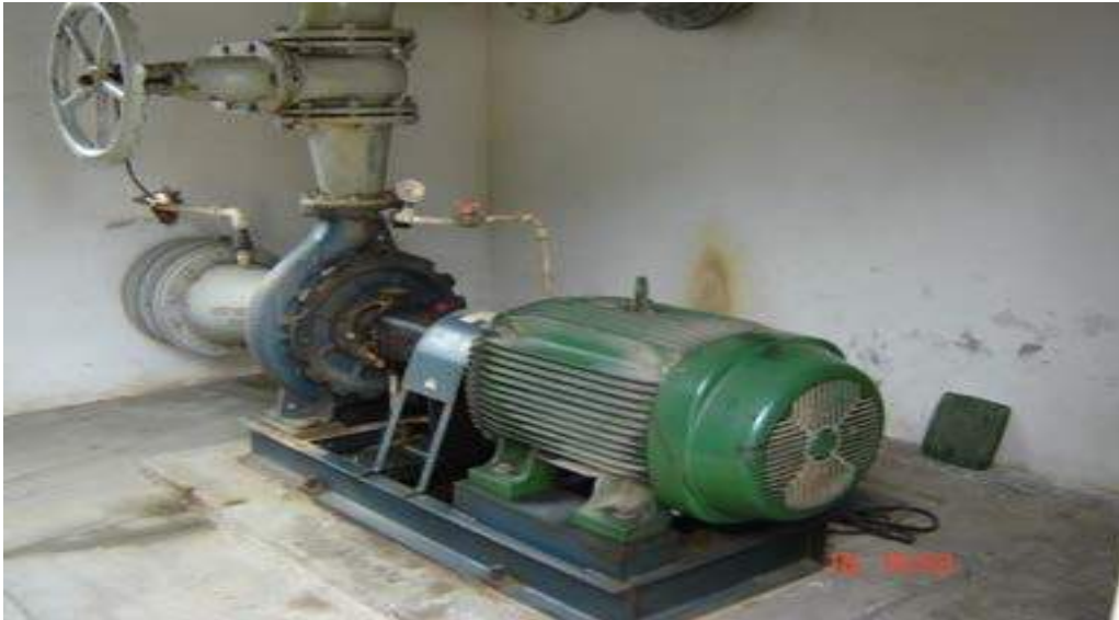
Ilustração 29 - Conjunto motobomba 1ª EEAT
