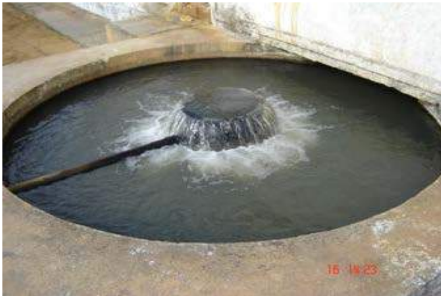
Ilustração 22 - Chegada da adutora de água bruta por gravidade
