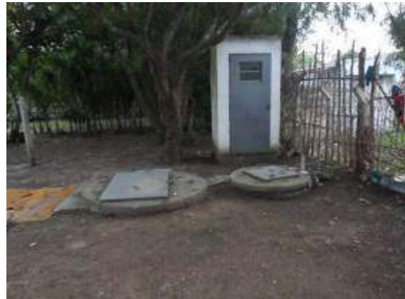
Quadro de comando ELE – Vila Castilho. (Fonte SANEP)
