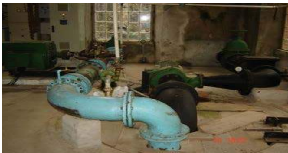
Ilustração 13 - Motores, bombas, tubulação e poço de sucção
