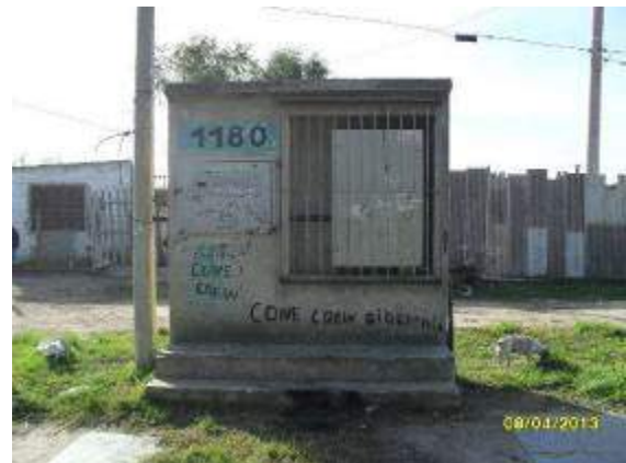
Quadro de comando ELE – L4. (Fonte SANEP)
