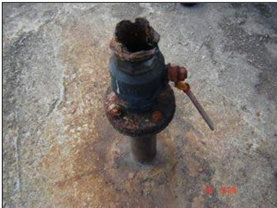
Figura 21 - Queimador de gás desativado (Fonte STE)
