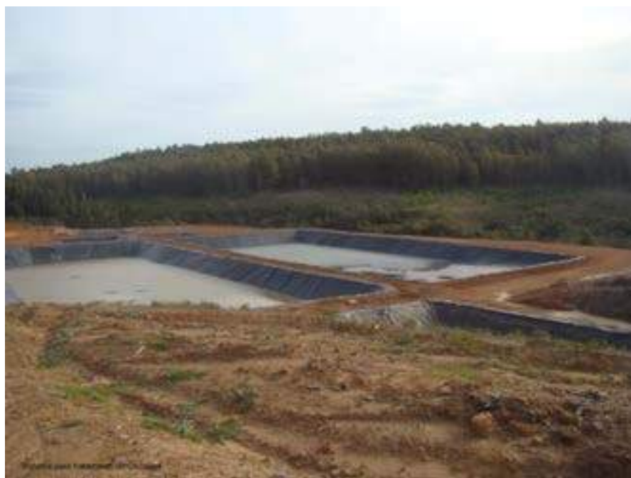
Figura 3.43 – Lagoas de estabilização para tratamento dos lixiviados
