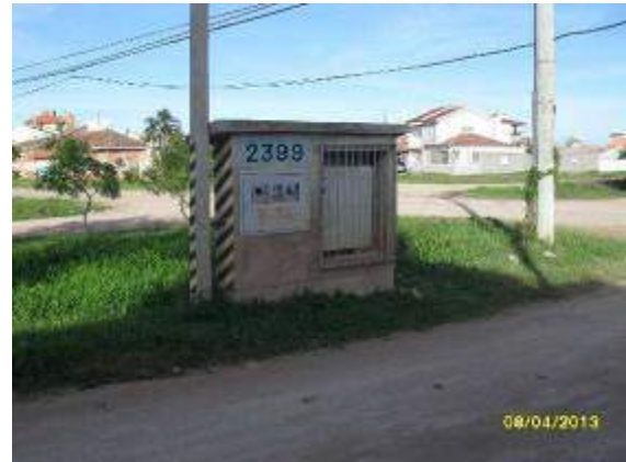
Quadro de comando ELE – L3. (Fonte SANEP)
