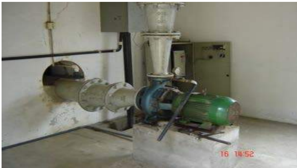
Ilustração 30 - Conjunto motobomba 2ª EEAT
