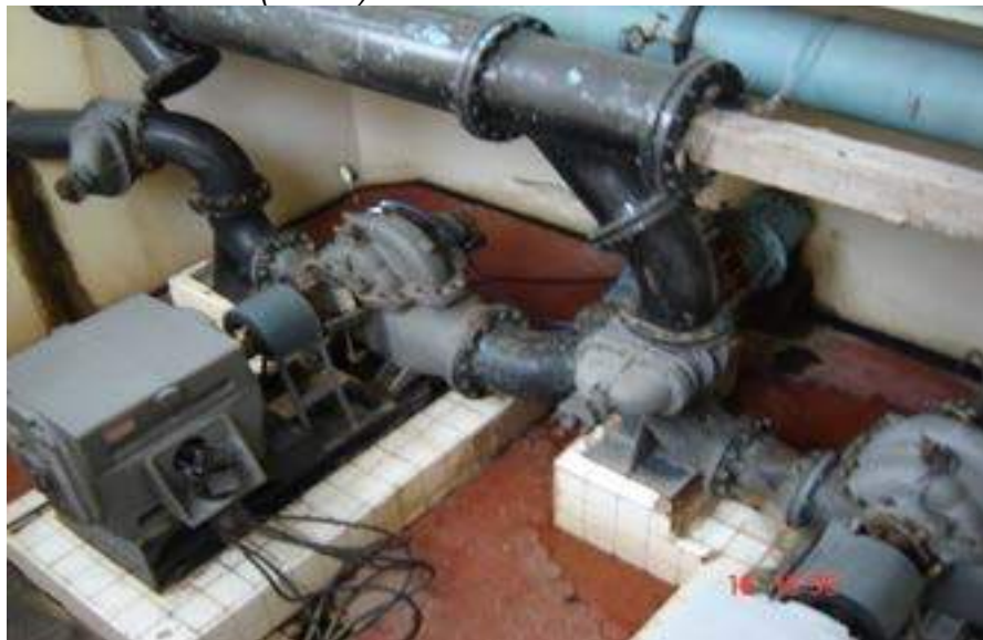
Ilustração 18 - Vista dos conjuntos motobomba 300 mm
