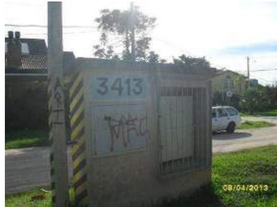
Quadro de comando ELE - L1. (Fonte SANEP)
