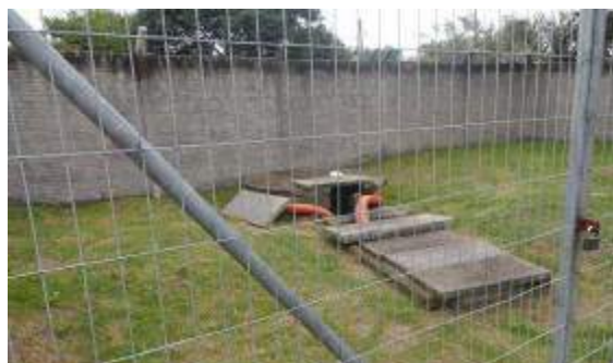
Local da Elevatória Cohab Lindóia. (Fonte SANEP)
