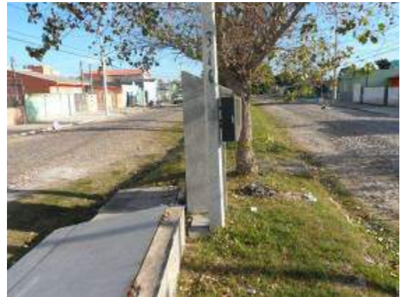
Quadro de comando ELE – Fátima. (Fonte SANEP)
