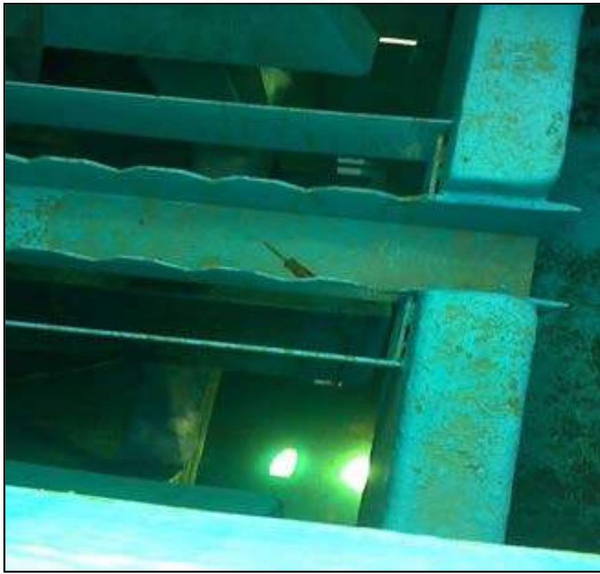
Figura 30 - Calhas internas dos reatores (Fonte STE)
