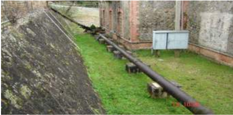
Ilustração 14 - Adutora 450 mm que segue para encontrar as redes por gravidade
