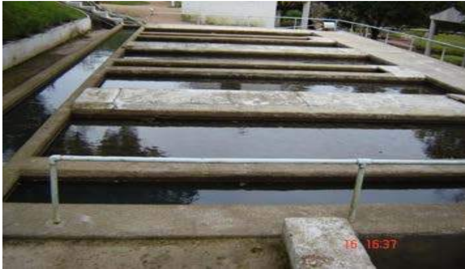
Ilustração 20 - Conjunto de pequenos tanques de filtração
