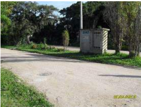
Local da Elevatória L2. (Fonte SANEP)
