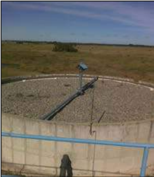
Figura 32 - Vista superior do filtro biológico (Fonte STE)
