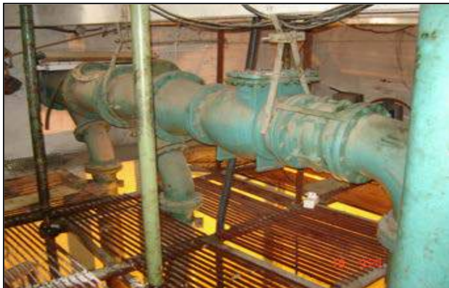
Figura 13 - Barrilete de recalque (Fonte STE)
