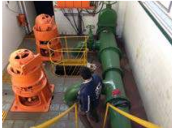
Sistema de bombas ELE – US-I (Fonte STE)
