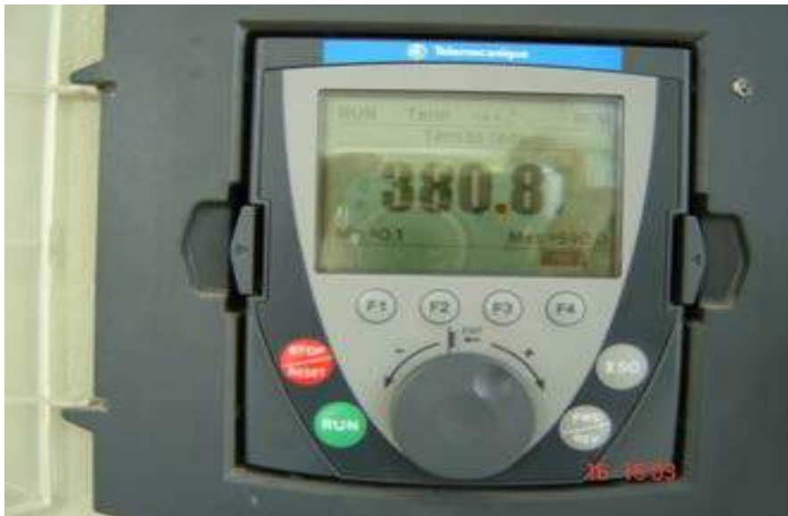
Ilustração 33 - macro medição adutora 4ª EEAT
