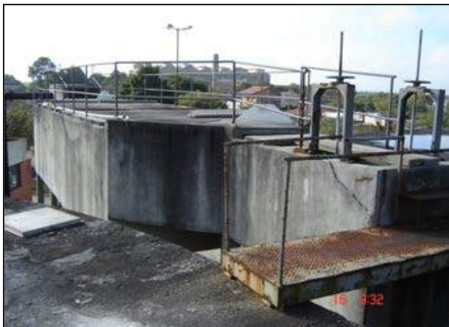
Figura 17 - Desarenador e calha Parshall (Fonte STE)
