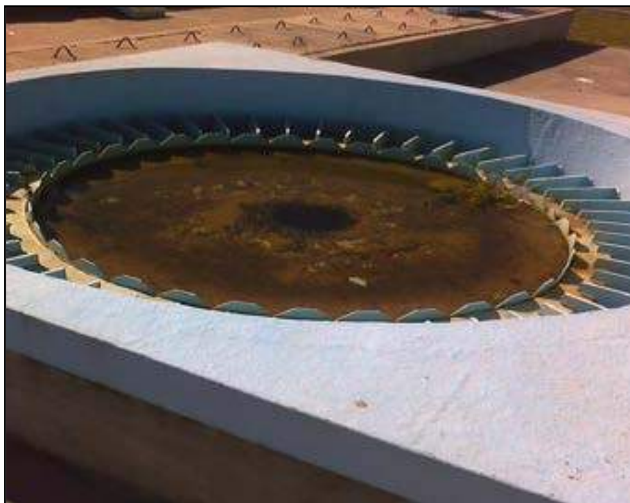
Figura 29 - Calhas de distribuição do esgoto bruto (Fonte STE)
