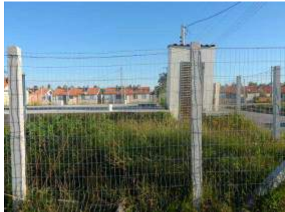
Quadro de comando ELE – Eldorado. (Fonte SANEP)
