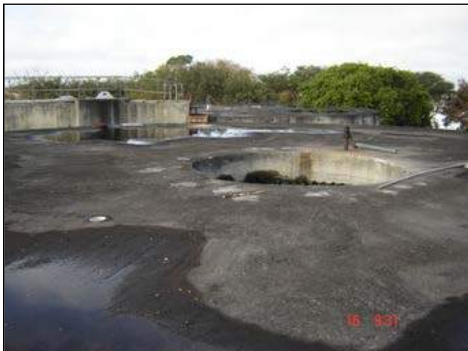
Figura 19 - Vista superior dos reatores (Fonte STE)
