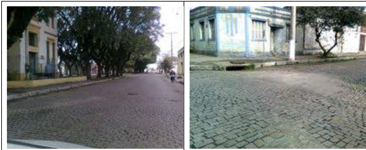
Figura 11: Dispositivos de microdrenagem superficial
