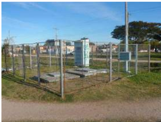
Local da Elevatória Meneghetti. (Fonte SANEP).
