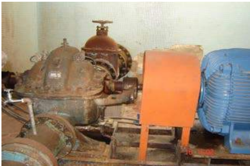
Ilustração 32- Conjunto motobomba 4ª EEAT
