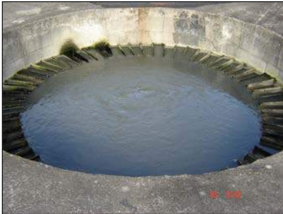
Figura 18 - Chegada do esgoto na parte superior do reator (Fonte STE)
