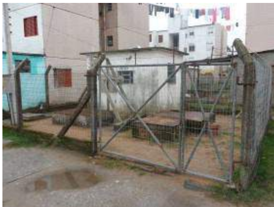
Local da Elevatória Cohab Pestano. (Fonte SANEP)
