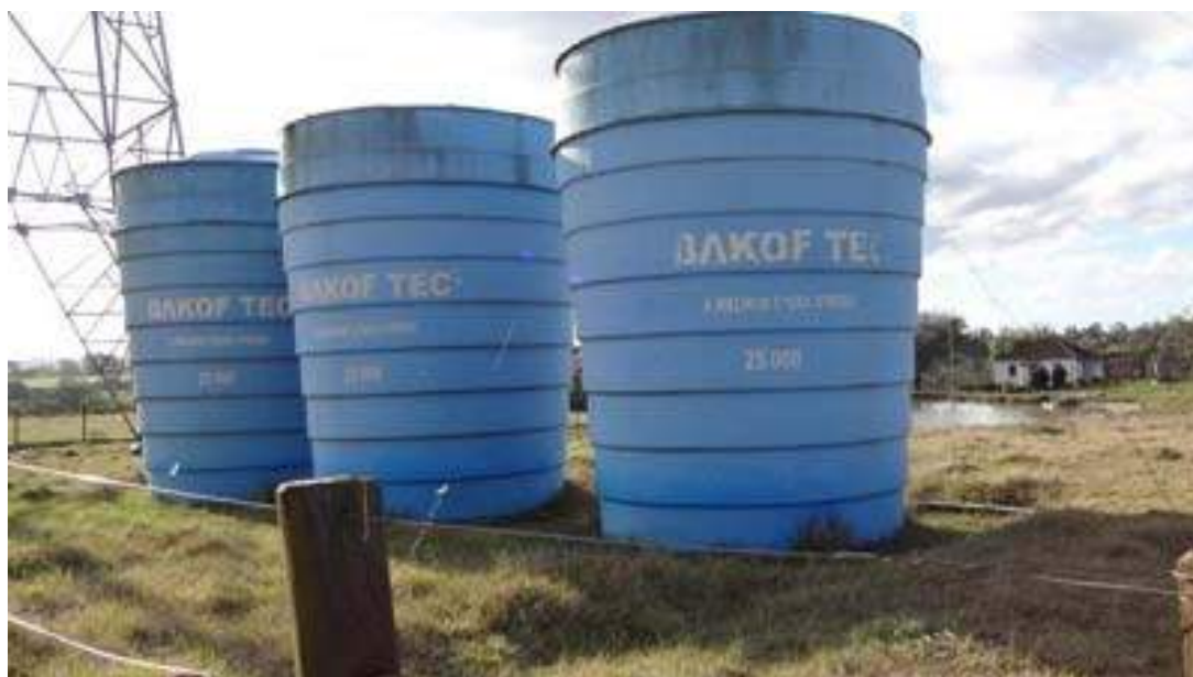
Ilustração 024 – Vista dos reservatórios, localizados na Colônia Corrientes.
