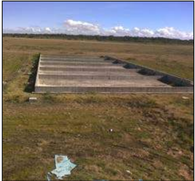
Figura 33 - Leitos de secagem de lodo (Fonte STE)
